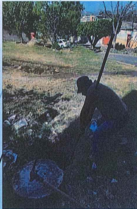
Sondeo y desazolve a drenaje general en la calle Ópalo esquina con García y Urquiza.
