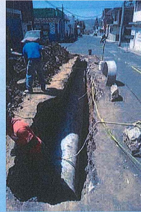
Rehabilitación de drenaje general en la calle Ierdo de Tejada Pte, esquina con Manuel Doblado Sur
